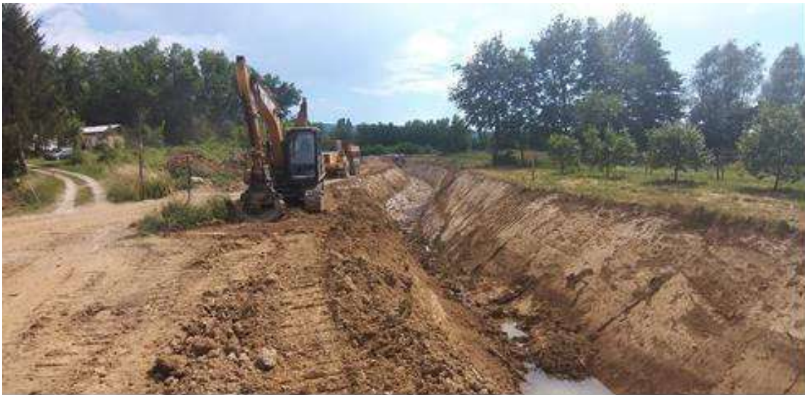
Slika 9 Povečanje odseka vodotoka "J2"
