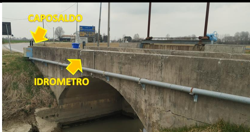
Figura 15 – Posizionamento idrometro e CS su ponte
