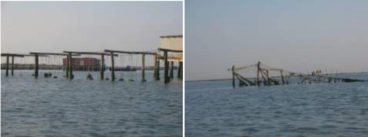
Foto 3.5: Strutture per mitilicoltura e degrado delle stesse.
