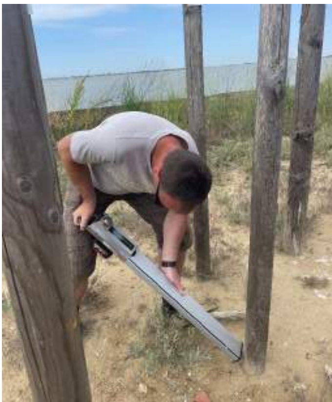
Immagine 13: Valutazione dello stato di degrado dei pali a Venezia mediante resistografo.
