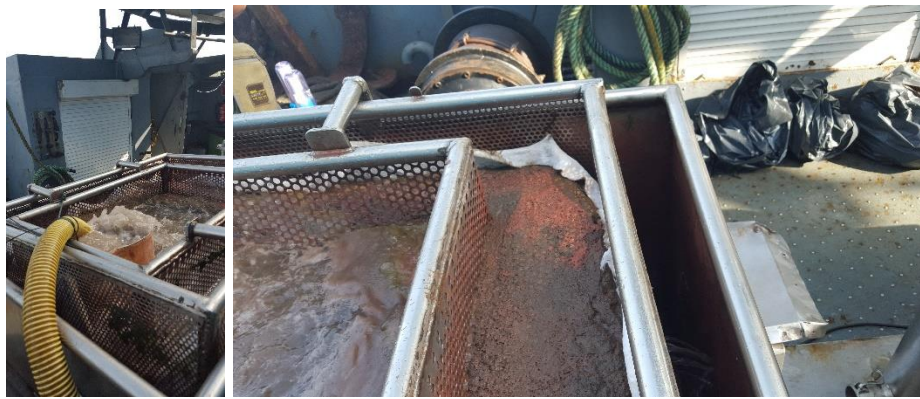
Fig. 12. Sistemi di filtrazione a 3 stadi 76 .
