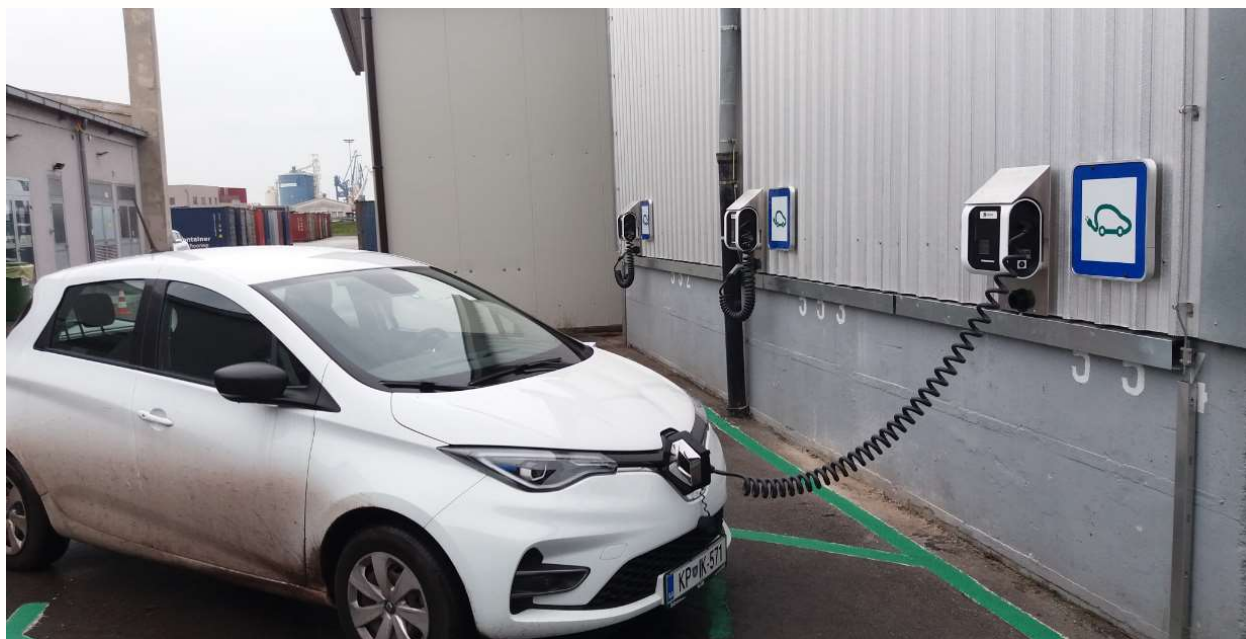
Figura 1: stazioni di ricarica per veicoli elettrici, installate presso il terminal auto
