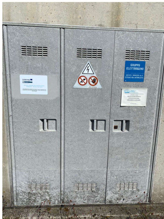
12 Foto targhe quadri elettrici
