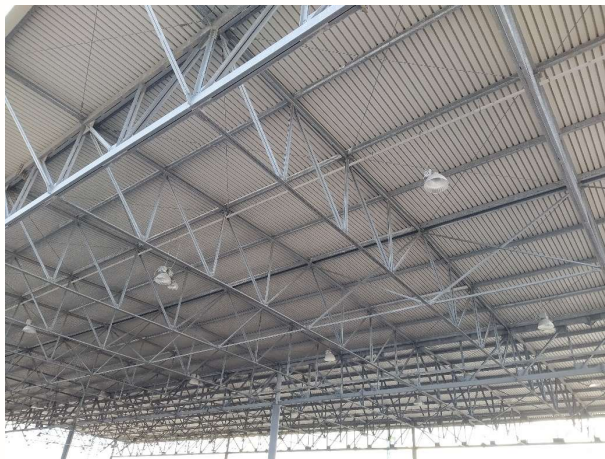
03 Fotografija razsvetljave nadstreškov
