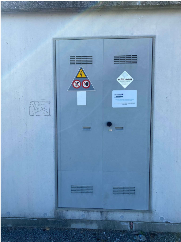
10 Foto targhe quadri elettrici
