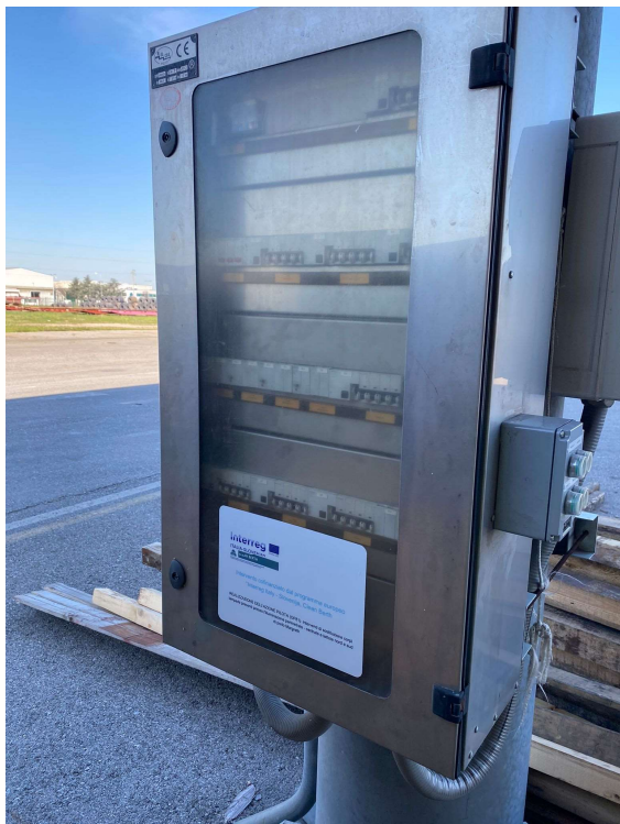
11 Foto targhe quadri elettrici
