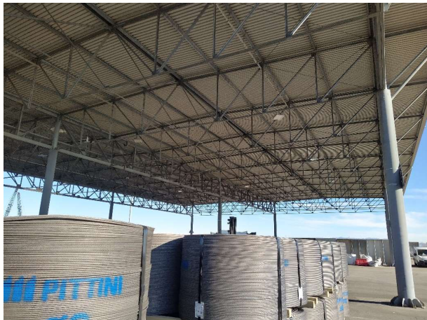
07 Fotografija nove opreme nadstreškov
