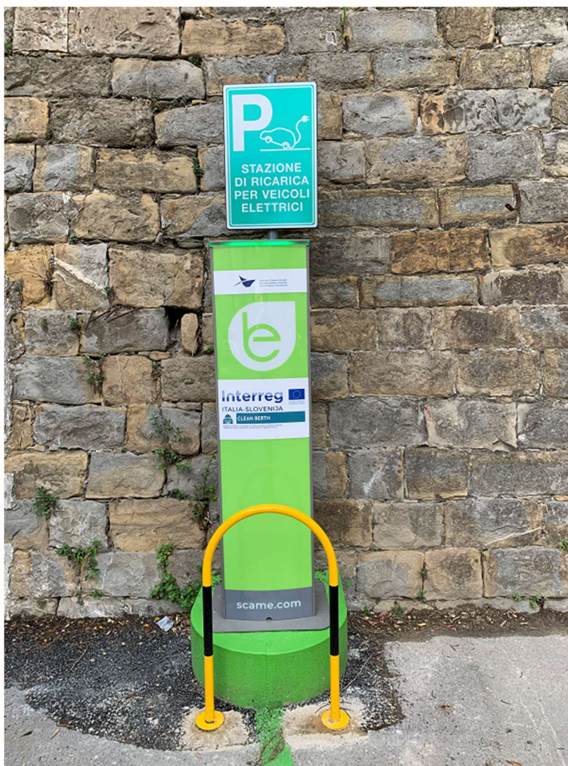
Figura n. 1 – dettaglio colonnina impiegata.
