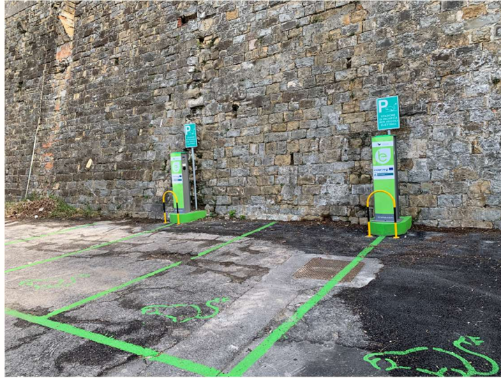
Figura n. 2 – Dettaglio posizionamento colonnine EV 1 e 2.
