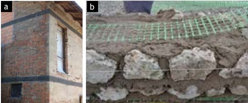
Fig. 4 Applicazione di catene eccentriche a livello di piano (a) e ricostruzione di cordoli sommitali in muratura armata (b).
