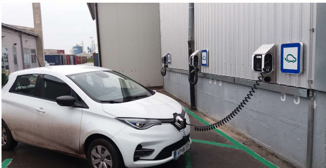
Slika 3: Stenske polnilnice za električna vozila na terminalu za avtomobile (Luka Koper)
