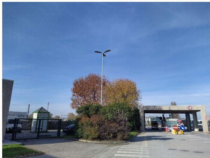
Slika 6: Svetilke na drogovih na vhodu v pristanišče z LED-sijalkami z močjo od 97 do 146 W (COSEF)
