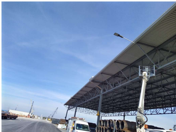
Slika 8: Svetilke na drogovih in objektih ob notranji cestni infrastrukturi pristanišča z LED-sijalkami z močjo od 134 do 146 W (COSEF)
